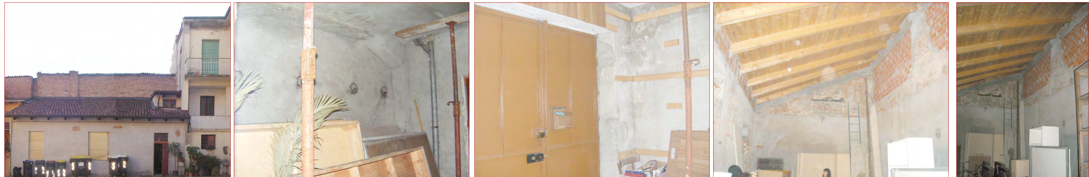
Immagini scattate durante uno dei sopralluoghi in situ. Si osservano alcune foto della struttura della "manica lunga". Da sottolineare alcuni locali con pali d'acciaio che puntellano la copertura.
